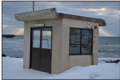
・町内バス停留所の老朽化状況
