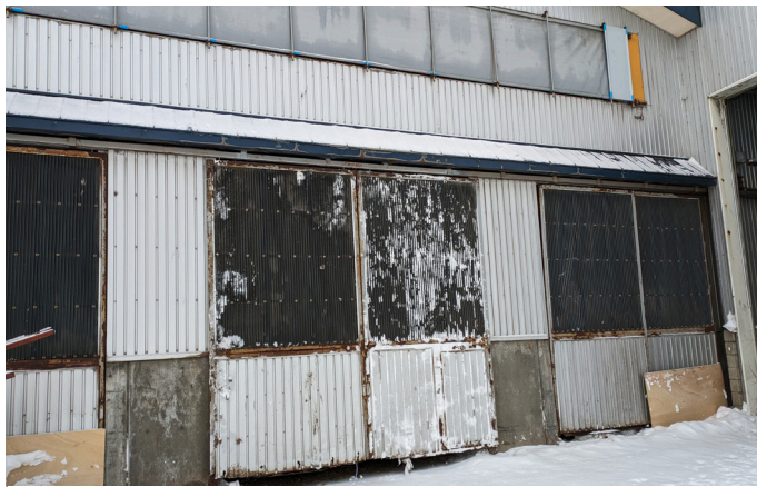
経年劣化した牧場施設
