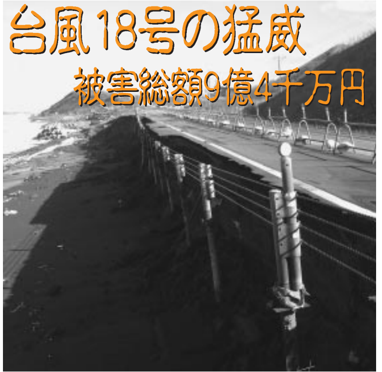
高波により一部決壊した国道232号線新場の沢付近
