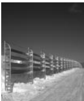
旭香川線に設置された防雪柵
