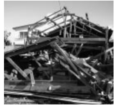
台風被害で押しつぶされた建物
