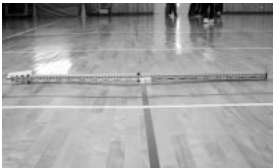
苫前小学校体育館床のゆがみを測定
